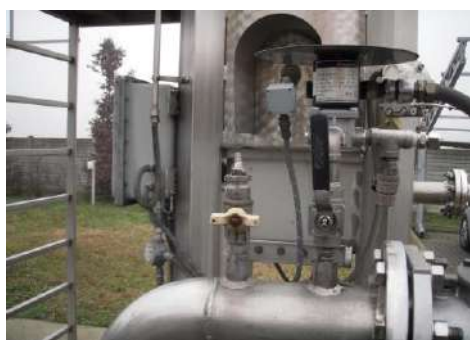
Figura 19: Beccuccio di prelievo del biogas
