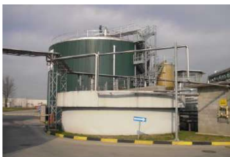
Figura 12: Ispessitore e digestore fanghi biologici
