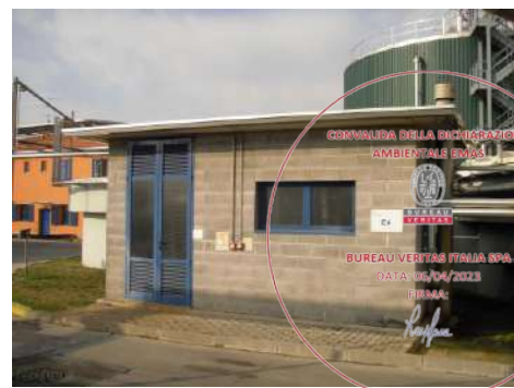
Figura 17: Locale caldaia, E4
