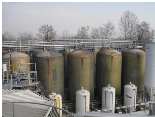
Figura 11: Serbatoi di stoccaggio (reflui e reagenti)
