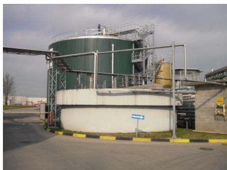
Figura 14: Ispessitore e digestore fanghi biologici
