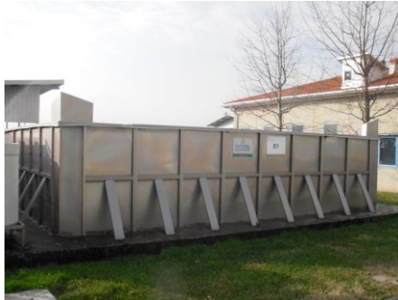
Figura 16: Biofiltro Syntal, E1
