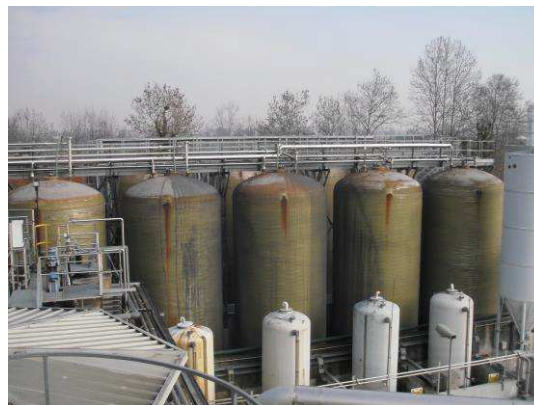
Figura 11: Serbatoi di stoccaggio (reflui e reagenti)
