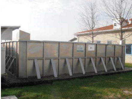
Figura 16: Biofiltro Syntal, E1
