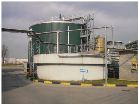
Figura 14: Ispessitore e digestore fanghi biologici
