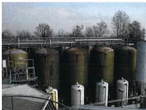
Figura 12: Serbatoi di stoccaggio (reflui e reagenti)
