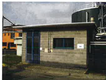
Figura 20: Locale caldaia, E4
