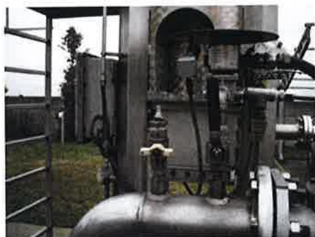
Figura 22: Beccuccio di prelievo del biogas
