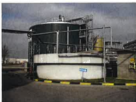
Figura 15: Ispessitore e digestore fanghi biologici
