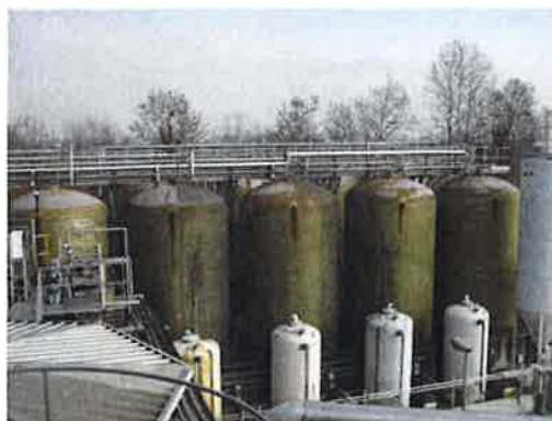
Figura 12: Serbatoi di stoccaggio (reflui e reagenti)
