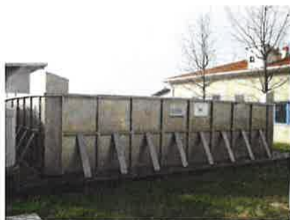
Figura 17: Biofiltro Syntal, E1
