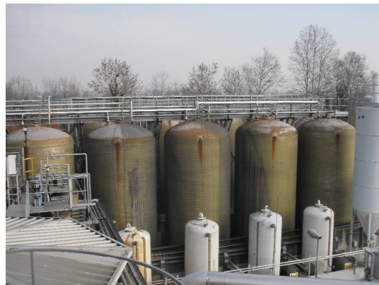
Figura 12: Serbatoi di stoccaggio (reflui e reagenti)
