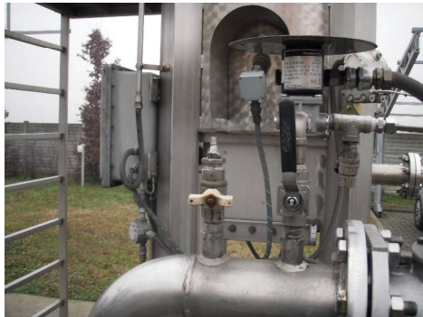
Figura 22: Beccuccio di prelievo del biogas
