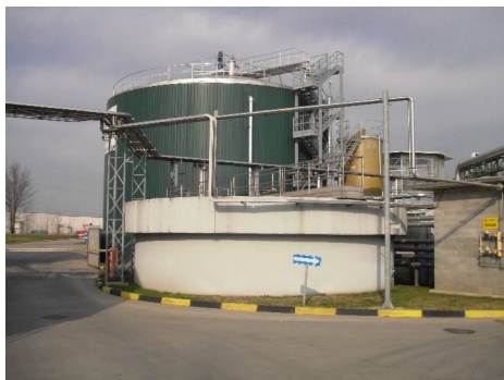
Figura 15: Ispessitore e digestore fanghi biologici
