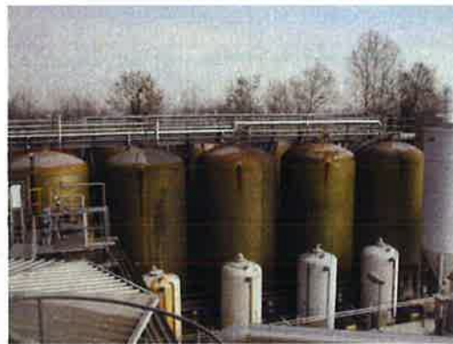
Figura 12: Serbatoi di stoccaggio (reflui e reagenti)
