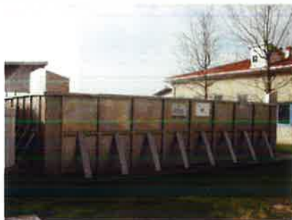
Figura 17: Biofiltro Syntal, E1
