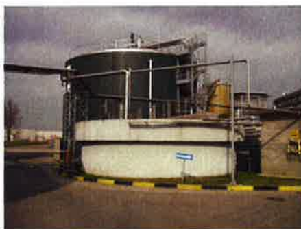
Figura 15: Ispessitore e digestore fanghi biologici
