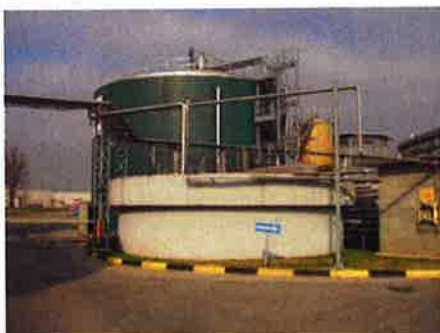
Figura 15: Ispessitore e digestore fanghi biologici
