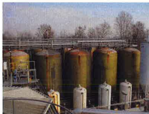
Figura 12: Serbatoi di stoccaggio (reflui e reagenti)
