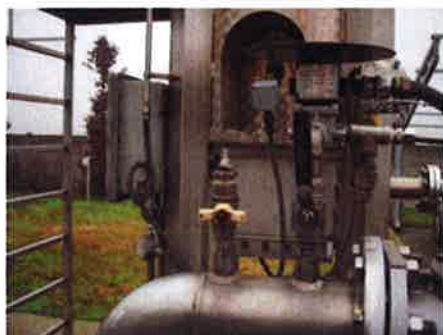
Figura 22: Beccuccio di prelievo del biogas
