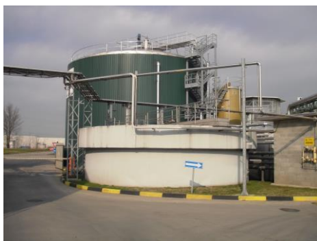
Figura 15: Ispessitore e digestore fanghi biologici
