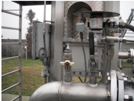
Figura 22: Beccuccio di prelievo del biogas
