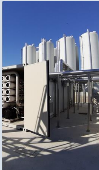
Impianto Depurazione Percolato
